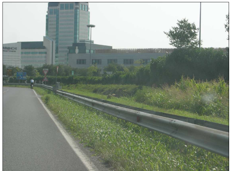
Posizione: Via Dante Tipologia: Impianti Conformi
